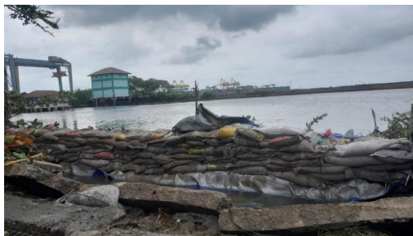
Gambar 3. Lokasi Kegagalan Tanggul Kolam Retensi
